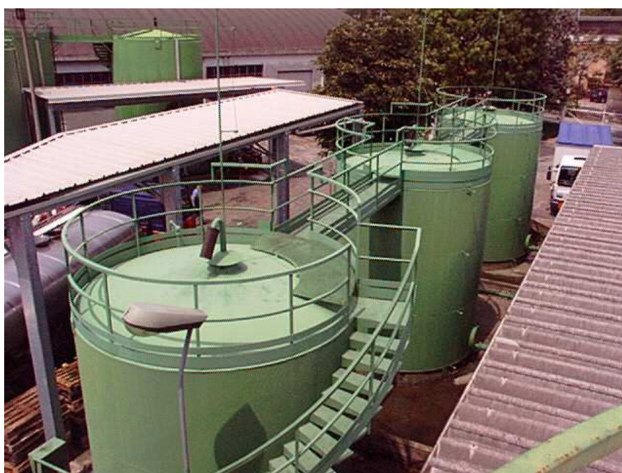
Fig. 2.1 – Panoramica di parte dei serbatoi di stoccaggio.
